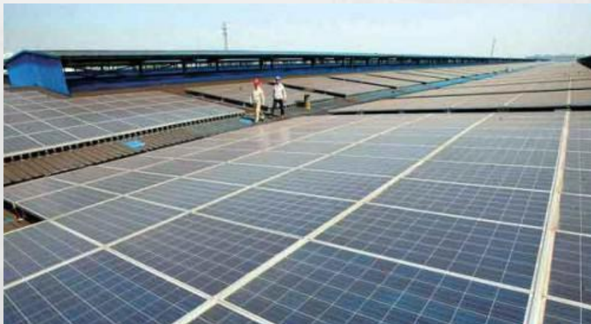
英利.靖江新扬子造船厂10MW屋顶光伏
