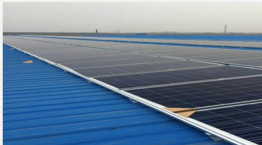
江苏舜天国信.泗阳荣马新能源5兆瓦屋顶光伏
