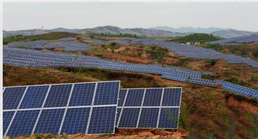
中电投承德县光伏项目
