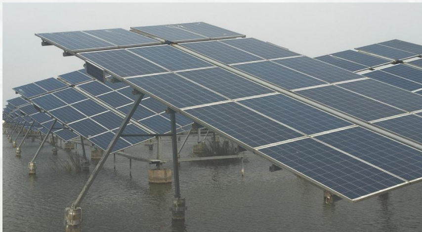
英利.盐城大丰草庙4.6MW渔光互补光伏
