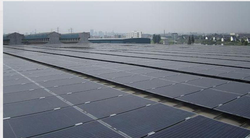
英利.溧阳国强镀锌实业有限公司5兆瓦屋顶光伏
